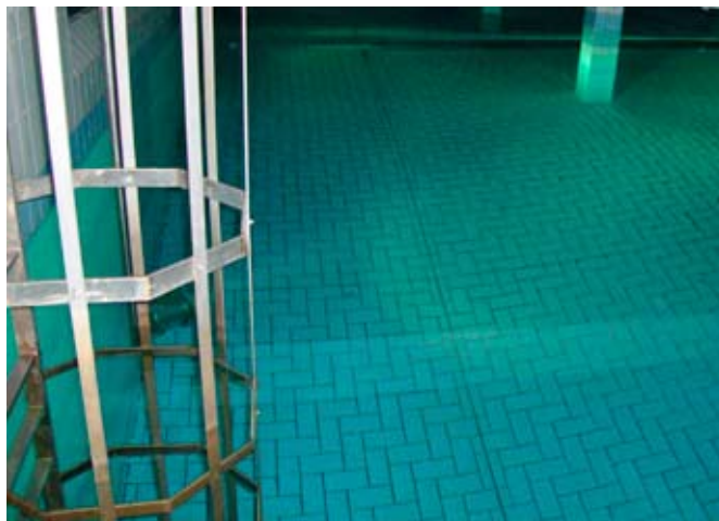
Serbatoio di accumulo di V. Cannizzaro (Hera S.p.a.)
