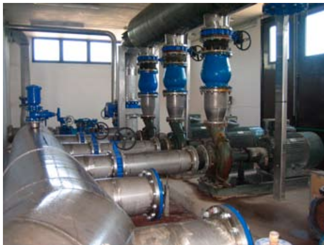
Centrale acquedotto di Castelfranco (Sorgeaqua)
